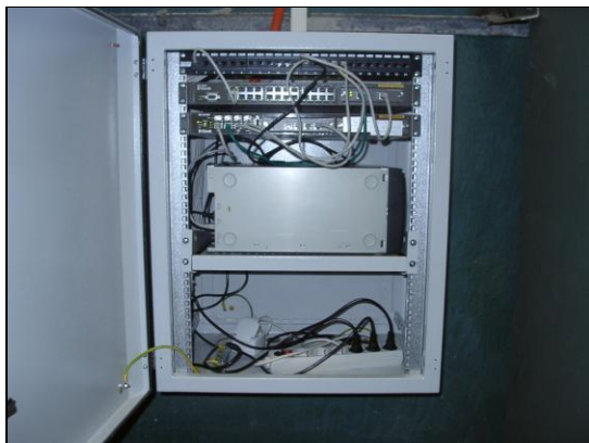
Рис. 3.3. Шкаф с сетевым оборудованием
